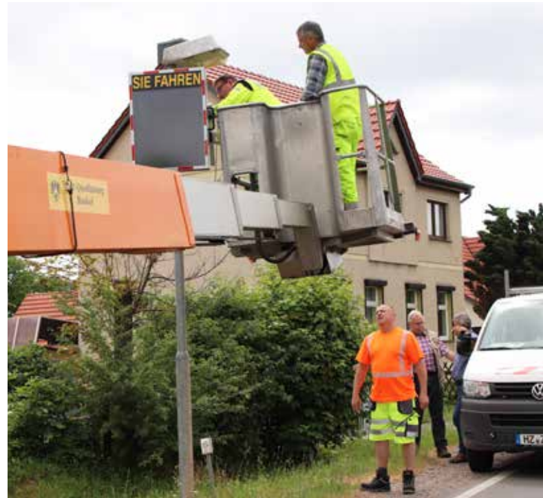
Die Mitarbeiter des Bauhofes installieren die Geschwindigkeitstafel am Ortseingang Bad Suderode während Ortsbürgermeister Gerd Adler mit Jens-Uwe Lilienthal die nächsten Aktivitäten bespricht.
